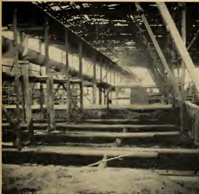
Shanks process leaching tanks. This installation is at the Oficina Cecilia of Compañía de Salitrera de Tarapacá y Antofagasta .
